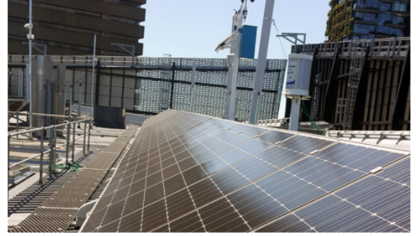
(b) PV array
